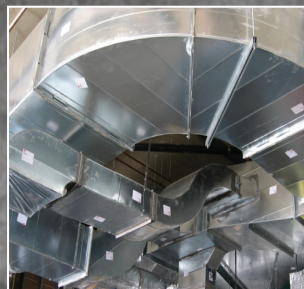
Conduite de ventilation
